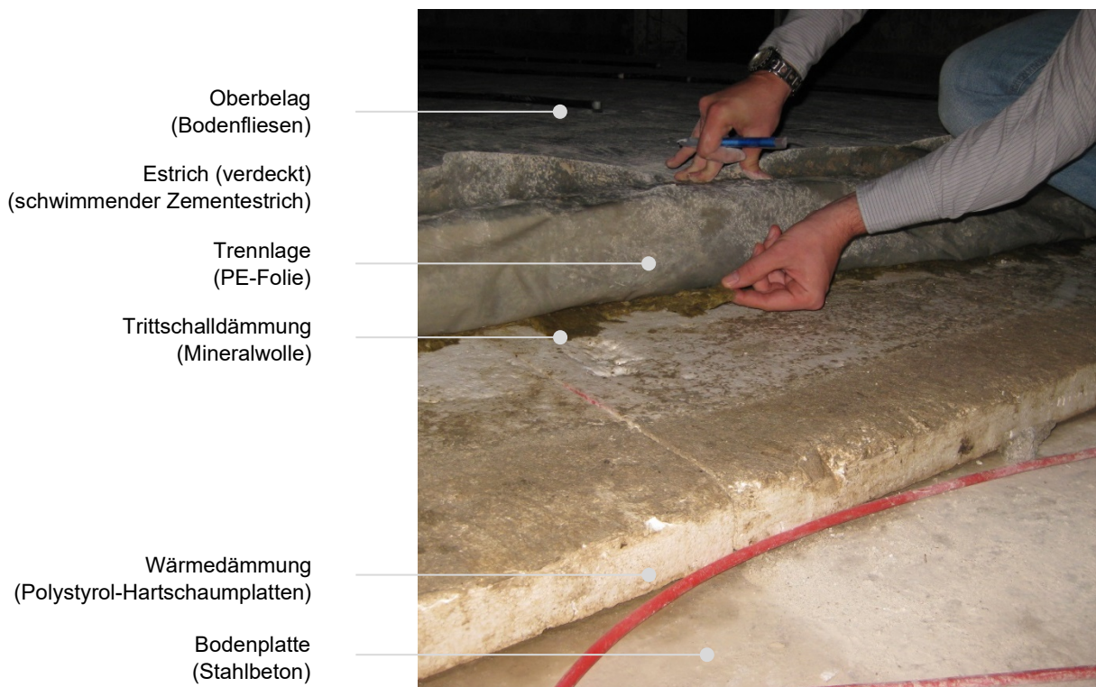
Abbildung 28: Überflutungsbeanspruchte Fußbodenkonstruktion: Schwimmender Zementestrich auf Trittschalldämmung und Wärmedämmung (Mineralwolle und Polystyrol-Hartschaumplatten) und Bodenfliesen. © HTW Dresden.
