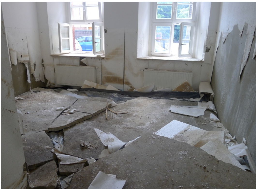
Abbildung 29: Fehlende Auftriebssicherheit einer Fußbodenkonstruktion in einem überfluteten Wohngebäude (hier: Zementestrich auf einer zweilagigen Wärmedämmung aus Polystyrol-Hartschaumplatten) führte zum Aufschwimmen und damit zu erheblichen strukturellen Schäden. © HTW Dresden.
